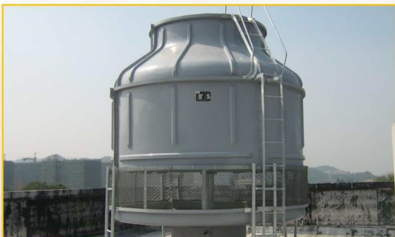
● Башня водяного охлаждения
